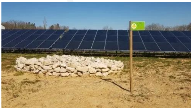
Pierriers – Centrale au sol de Boulogne-sur-Gesse
